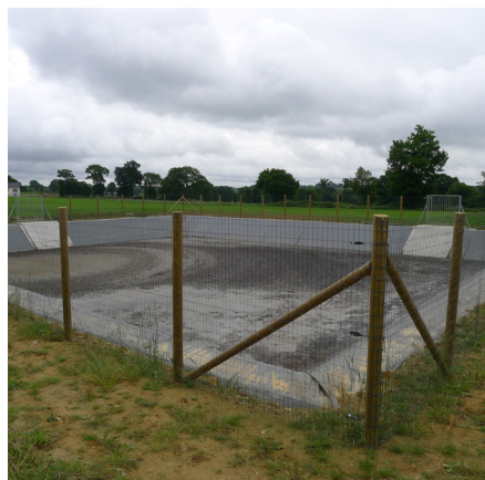
Exemple de fosse à lisier clôturée
